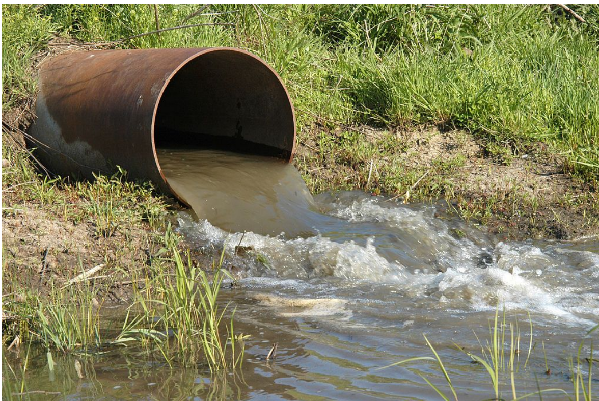
Fonte: Discharge pipe. In: Wikipedia . Disponível em: < https://pt.wikipedia.org/wiki/Efluente#/media/File:Discharge_pipe.jpg >. Acesso em: 24 fev 2019.
