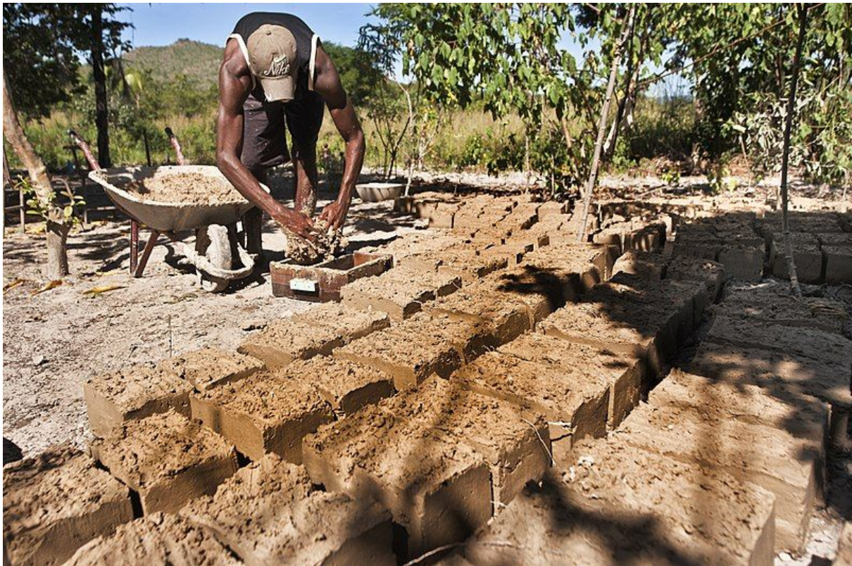
Francisco dos Santos fabrica tijolos de adobe, seguindo técnicas ancestrais. Quilombo do Vão de Almas, Cavalcante-GO.
